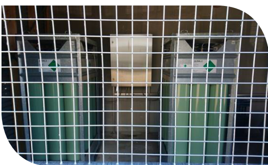
Batteri med CO 2 flasker i et aflukket skur. Ved større forbrug anvendes kryotank i stedet for batterier.
